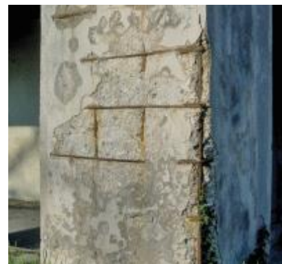
Phénomène de corrosion d'un pilier en béton
