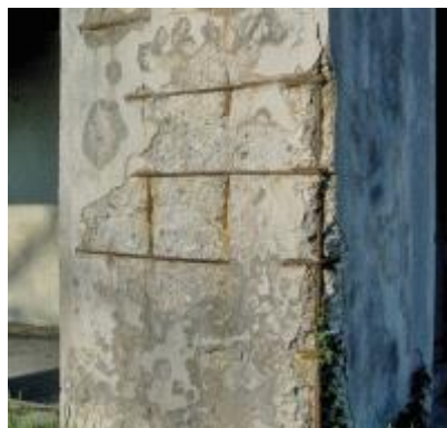
Phénomène de corrosion d'un pilier en béton
